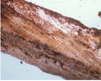
Fig. 14: Asitten etkilenmiş bir ahşap. Fig. 14: Acid-affected timber.
