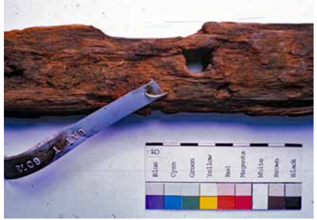
Fig. 18: Gazlı amonyak ile asitten arıtılması tamamlanmış asitten etkilenmiş ahşap. Fig. 18: Acid-affected timber after deacidification with gaseous ammonia.
