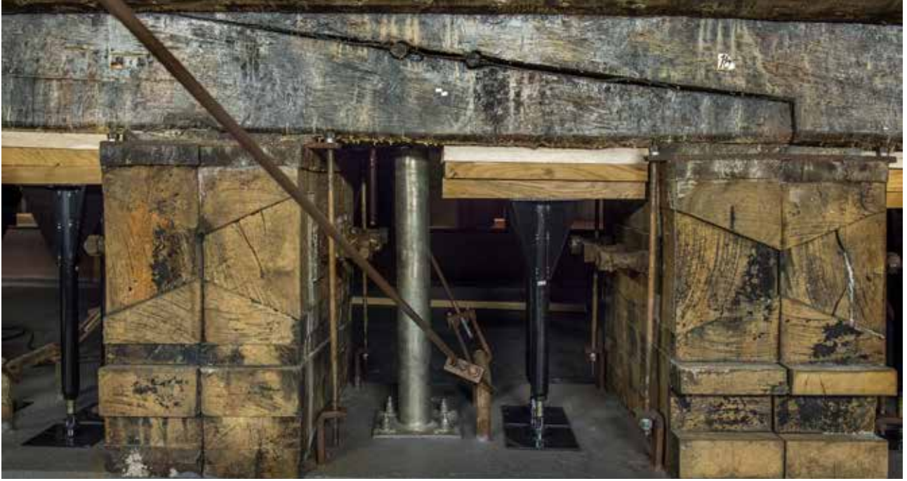
Fig. 14: Omurga bloklarının aralarına 1960’larda yerleştirilen ayarlanabilen çelik vida destekleri. Görülen diğer çelik kolon ana direğin ağırlığını taşıması amacıyla 1990’larda eklenmiştir.
